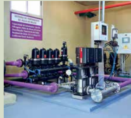
GS INIMA AMBIENT EFFLUENT REUSE SYSTEM
